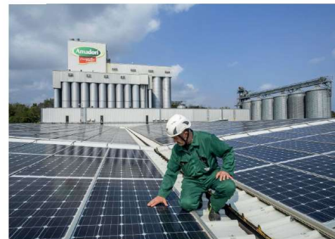
Pannelli fotovoltaici da Amadori
