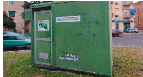
Una centralina Arpae: da poco ne è stata installata una a Marina
