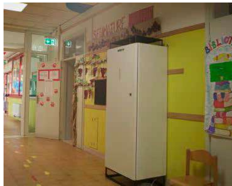
Uno dei sanificatori posizionato all'interno di una scuola
