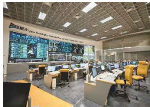
Il moderno polo di telecontrollo di Hera a Forlì, struttura all'avanguardia e unica a livello nazionale
